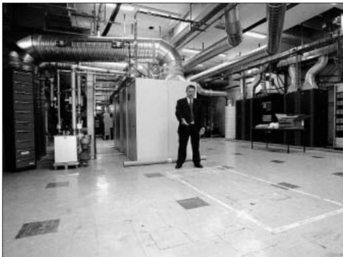
Daniel Paillot indique l'emplacement qu'occupera le prochain multiplexeur à côté de ceux déjà actifs.
